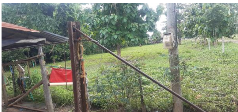
Ilustración 10. Torre de soporte con terminal con anclajes y templadores
